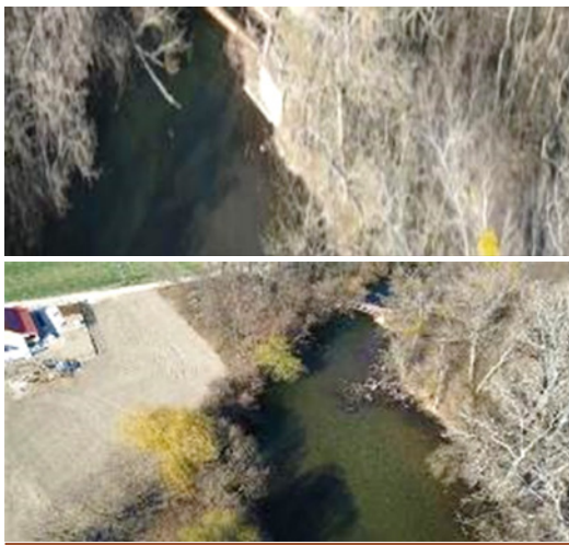
Obr. 5.56 Nefunkčný most v úseku a výstavba v ochrannom pásme
